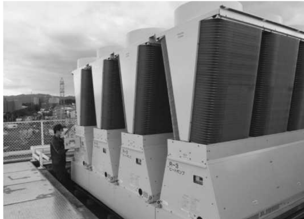
精密ガラス加工センターに導入した空冷ヒートポンプチャラー。冷温水に関わるCO 2 排出量を従来比60%削減した
