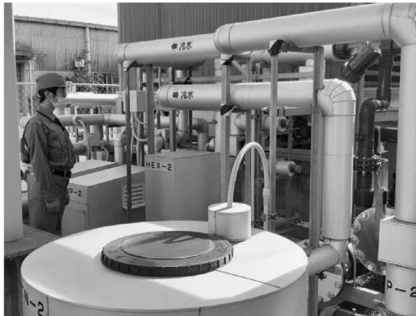
新充電工場の屋外の狭いスペースに設置されたヒートポンプ設備
