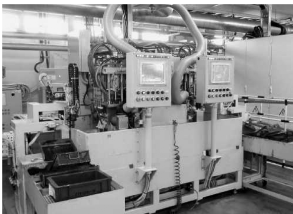
FD-iOTをテスト運用している富士電子工業の工場内の設備（富士電子工業提供）
