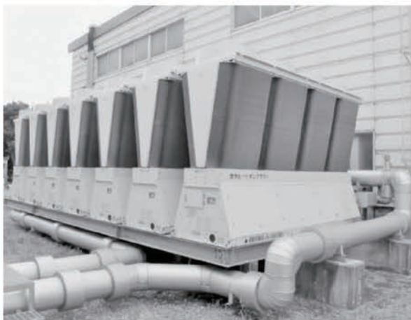
工場敷地内の空冷ヒートポンプチラー
