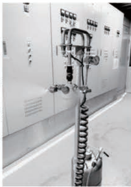
クリーンルーム床下に配置されたドライフォグシステム
