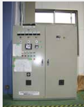
塗装設備制御盤
