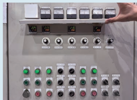
▲ カーボンヒーター制御盤
