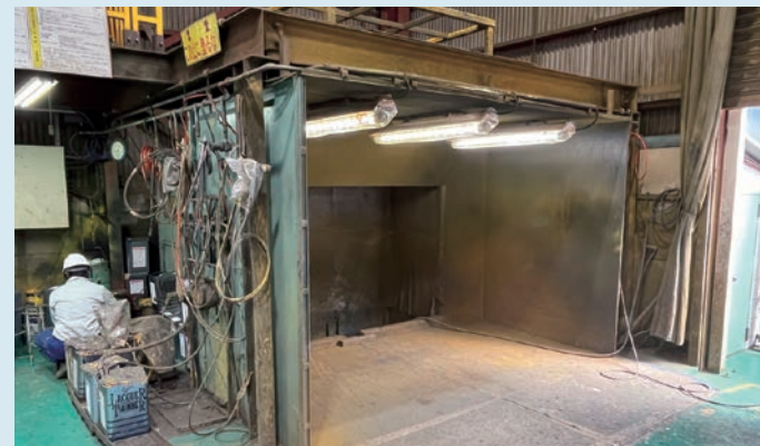
▲ 溶剤塗装用の大型乾式塗装ブース
