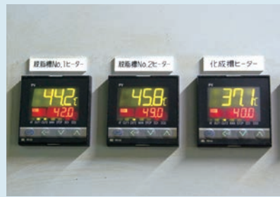
▲ 前処理槽廃熱回収温度調節器
