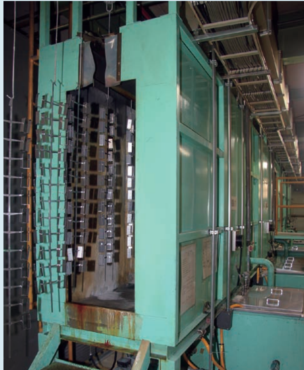
▲ 硬化炉熱で前処理液の加温を行っている前処理設備
