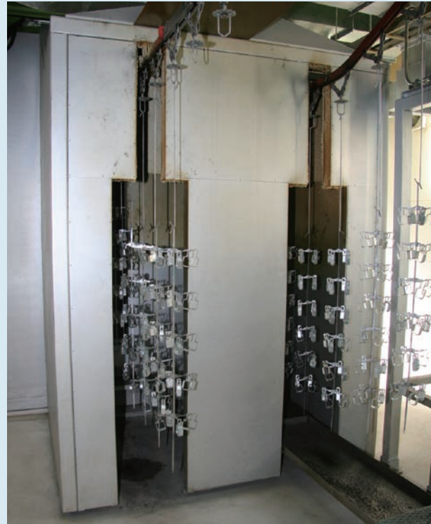
▲ 硬化炉の廃熱を熱源にしている水切り乾燥炉
