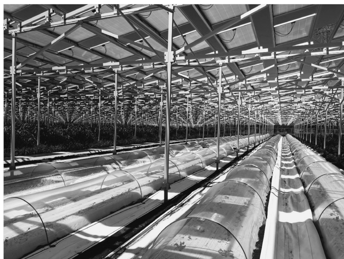
図 1 営農型太陽光発電（ソーラーシェアリング）設備の例
