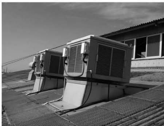
写真1 屋根上への設置例
