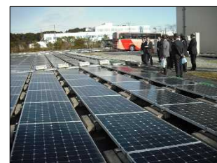
写真3 太陽光発電設備
