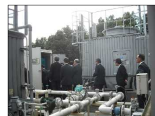
写真4 熱電供給プラント
