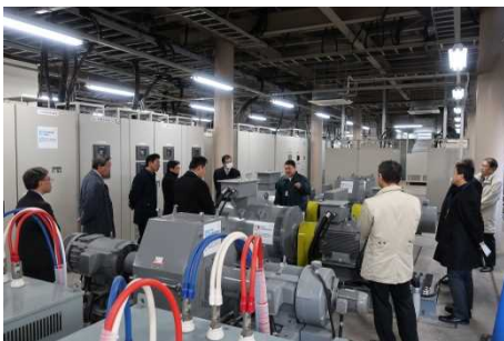
写真 1 設置されている発電機群
