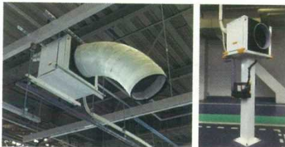
ダイキン工業 堺製作所 臨海工場での設置例
