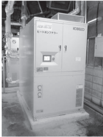
新たに導入したヒートポンプで飲料の加熱殺菌工程を省エネ化
