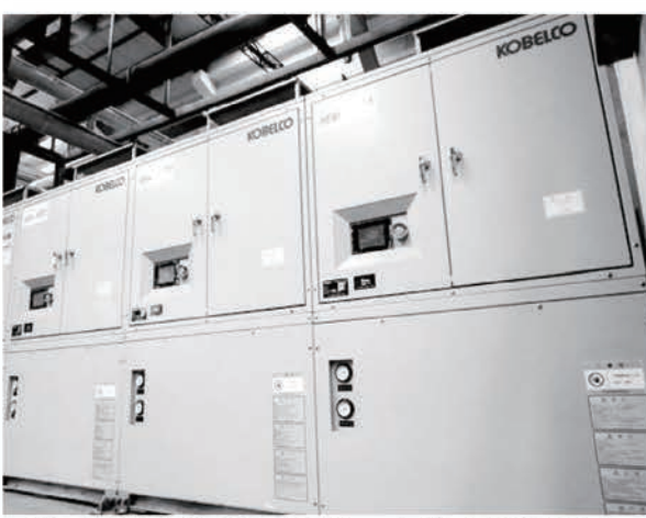
冷・温水を同時供給できるヒートポンプを納入した
