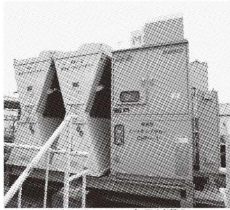
エム・シーシー食品が導入した熱回収ヒートポンプ
