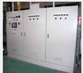
ハイブリッド硬化炉の制御盤
