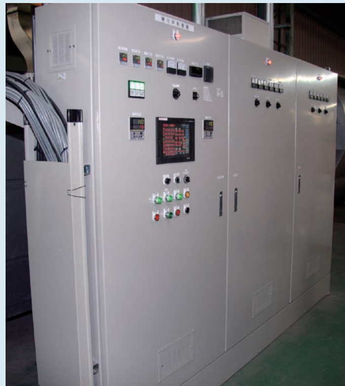
乾燥炉制御盤 ▲
