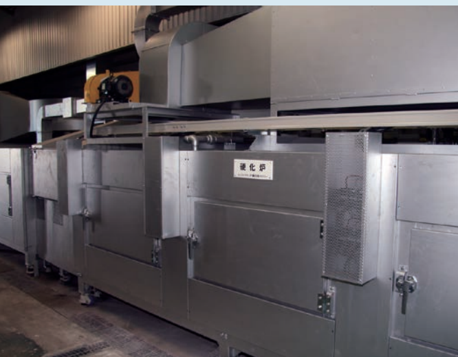
▲ ハイブリッド硬化炉
