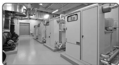
蒸気発生器「蒸気源」
