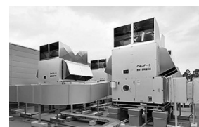
地中熱利用ヒートポンプ
