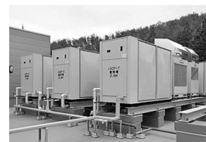
氷蓄熱式空調システム
