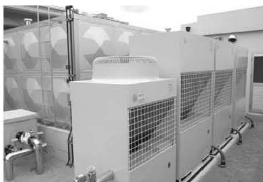
▲入替後の業務用エコキュートと貯湯槽（呼称 30m 3 ） （手前の1台は水風呂冷却用の空冷チラー MCAV-P 224A）
