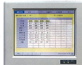
設備管理室に 設置された コントロールパネル
