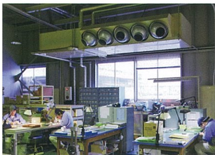
第一工場棟の空調吹出口
