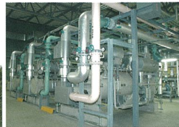
ターボ冷凍機
